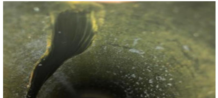
Bild 1: Fotoaufnahme des Innenrohrbereiches der Trinkwasserleitung
